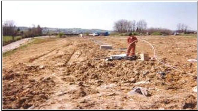
Vue générale d'une installation
